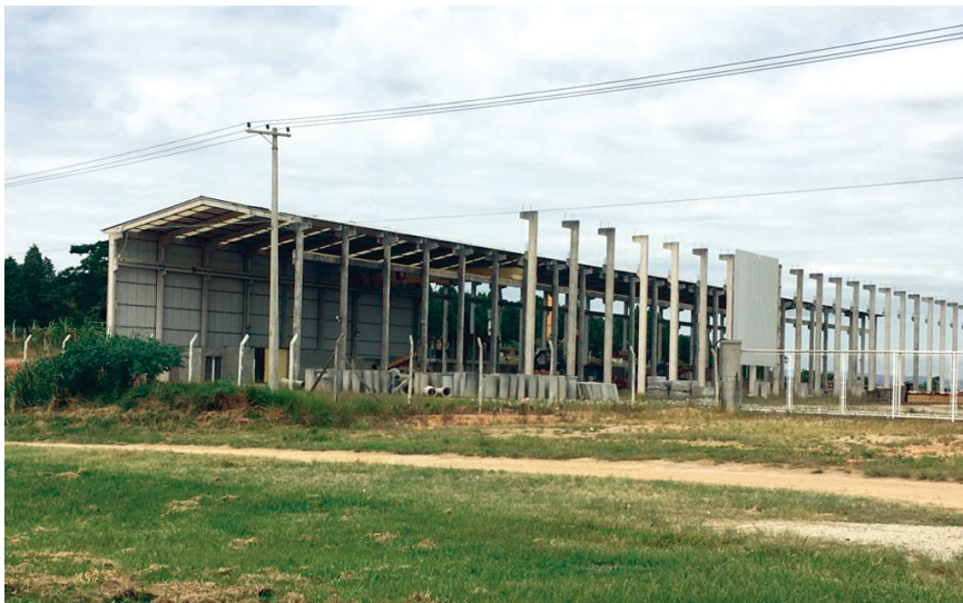
Obras interrompidas no início da construção
